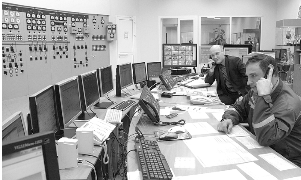
Начальник смены станции Константин Бурнышев и дежурный электромонтёр Дмитрий Кириенко на главном щите управления Воткинской ГЭС.
